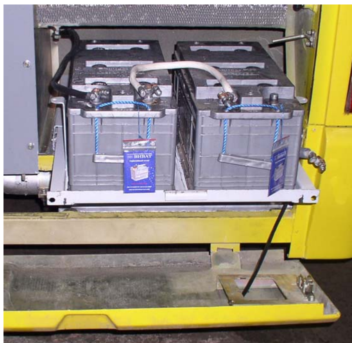
Рисунок 6.1– Расположение аккумуляторных батарей
